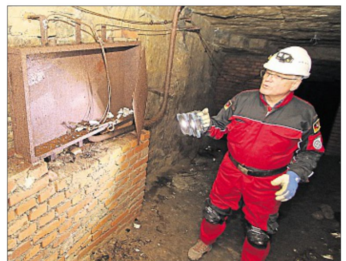
Wohl Reste eines alten Sicherungskastens: Der Bunker war mit elektrischem Licht ausgestattet, auch Leitungen sind erhalten.
